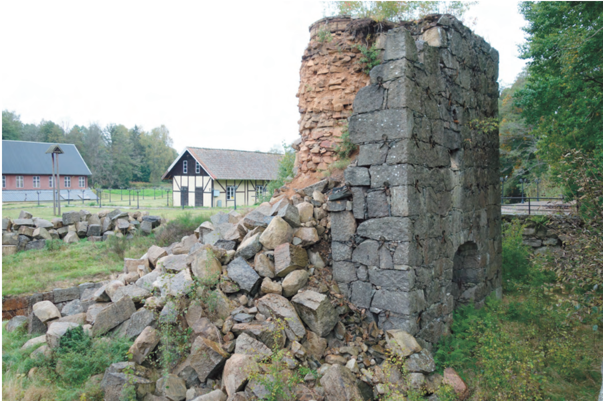
Masugnen sedd från öst. Den intakta norra sidan och den rasade sidan mot söder. Rasmassor på motsatt sida av kanalen syns även i bakgrunden.
